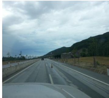
Hình 1. Hần lún vệt bánh xe trên QL1 đoạn Vinh - Hà Tĩnh (ngày 13-6-2014)
